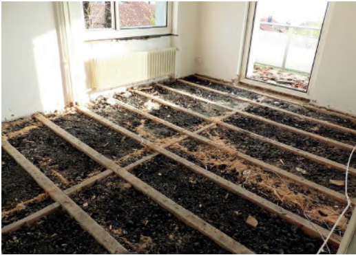
In Hohldecken können sich schwermetallhaltige Schlacken verbergen.
