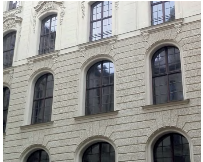
Justizpalast München: Blick auf die Isolierglasfenster des östlichen Innenhofs mit mundgeblasenem Glas.
