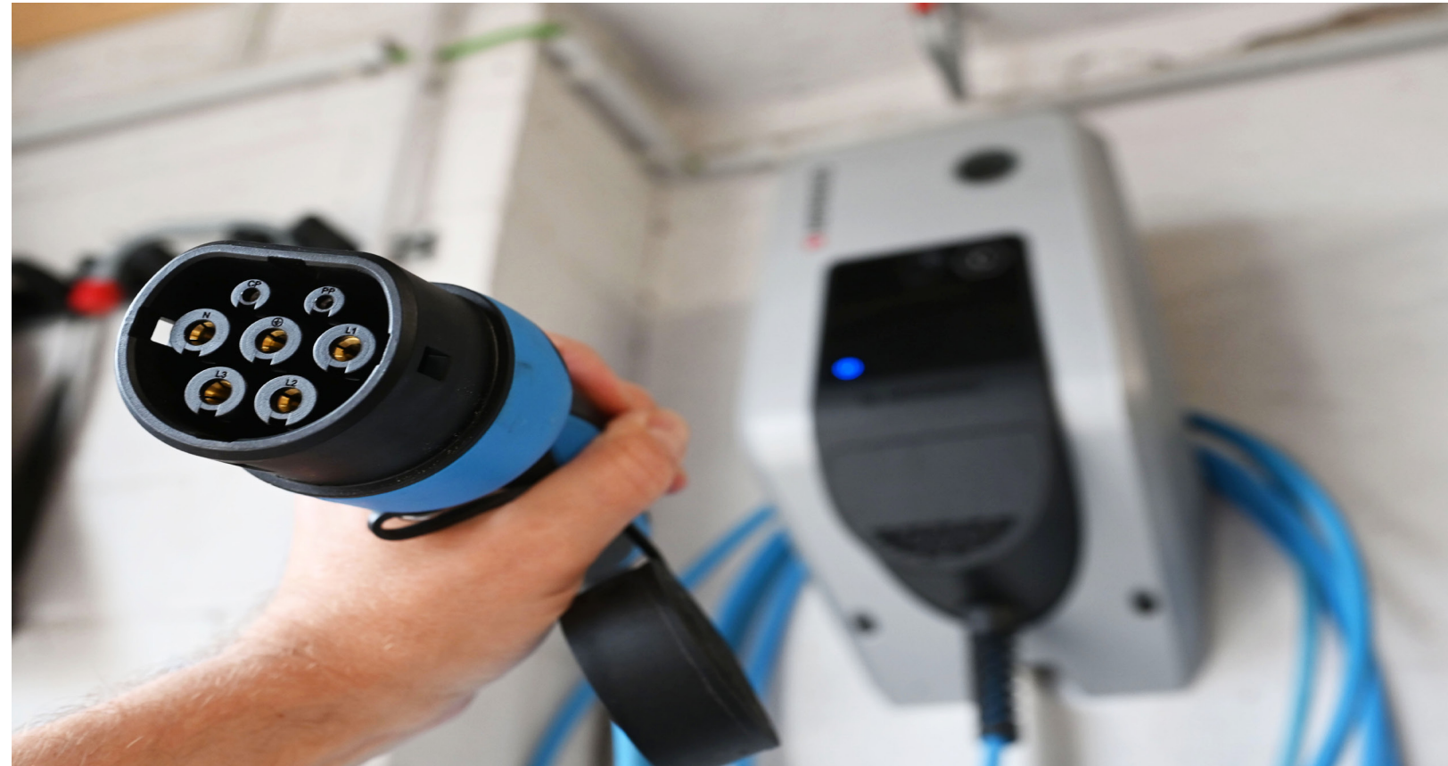
Der Ausbau der Elektromobilität könnte Auswirkungen auf den baulichen Brandschutz, etwa in Garagen mit Ladesäulen haben. FOTO: DPA/ULI DECK
